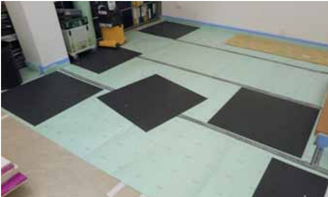
Vorbereitung des Untergrundes für die Verlegung der Vinyl-Fliesen (Foto: Peter Paul Schepp)
